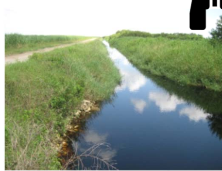
Sumidero o trampa antes de la estructura de descarga (Mantenimiento)
